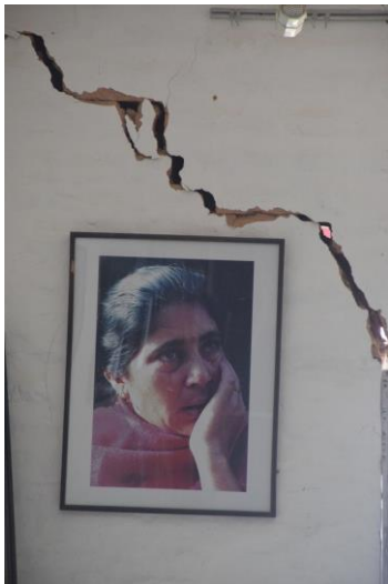
ひび割れした展示室
