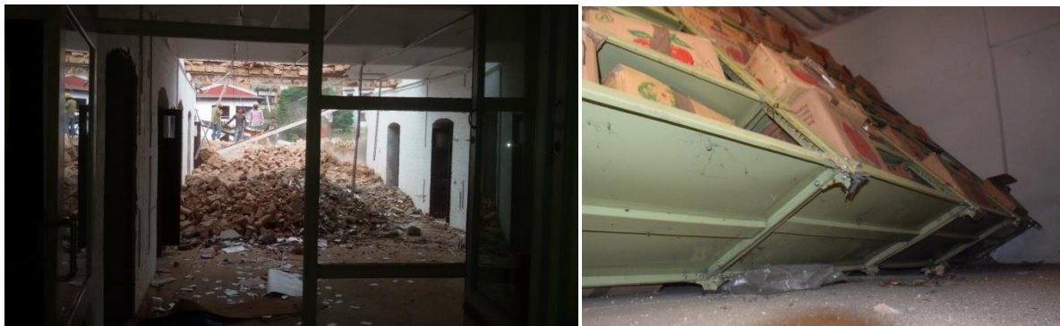
地震で被災したマダン図書館1階と倒壊書架
